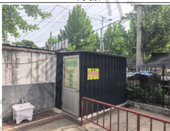
地埋式污水处理站
