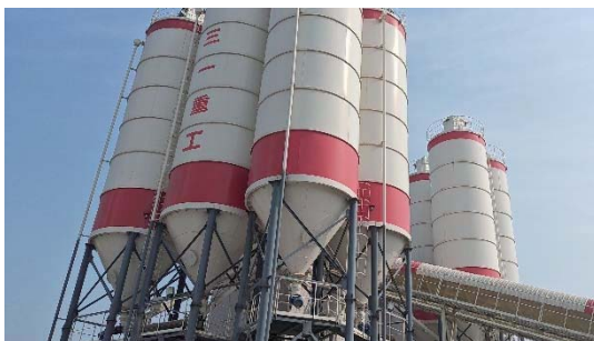
现有项目搅拌站及料仓
