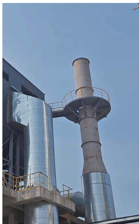
1#线排气筒及采样平台
