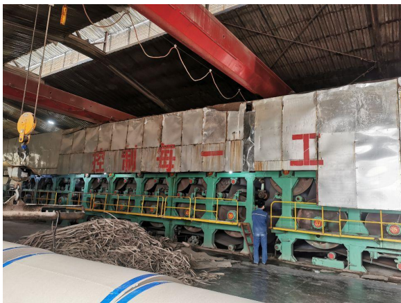
2#生产线瓦楞原纸生产车间
