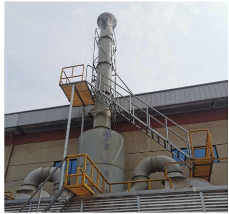
废气喷淋设施及废气排放口
