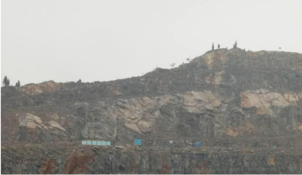
照片 2-3 矿山 A 区台段边坡治理前现状
